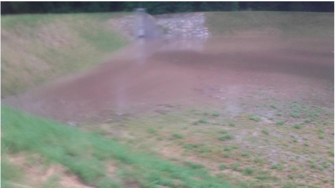
Foto 26 - Torrente Vellone, livello dell'acqua nella vasca di laminazione (evento piovoso del 7 Giugno 2020).
