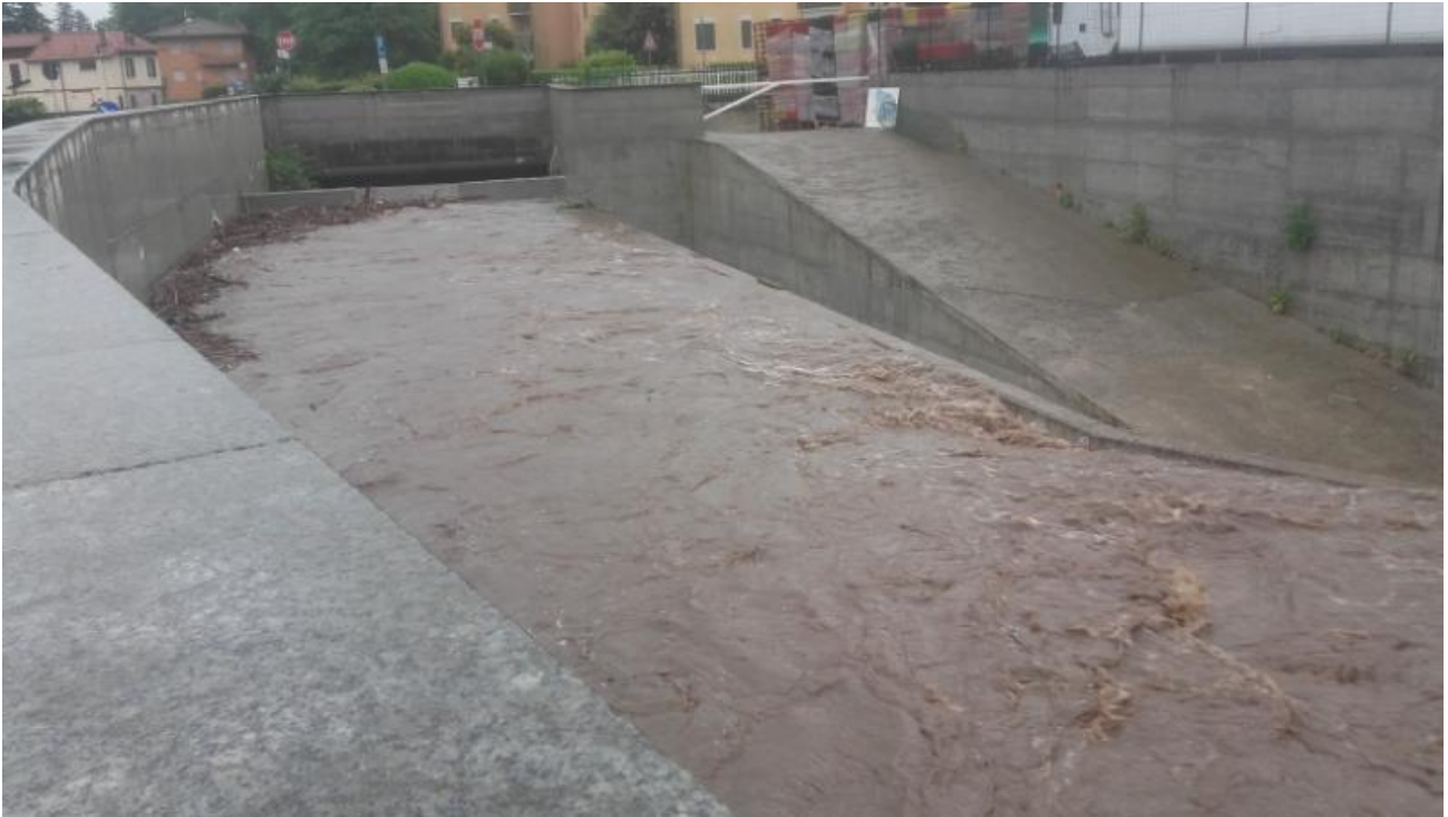
Foto 25 - Torrente Vellone, modulatore completamente invasato con scarico acque nello scolmatore (evento piovoso del 7 giugno 2020).
