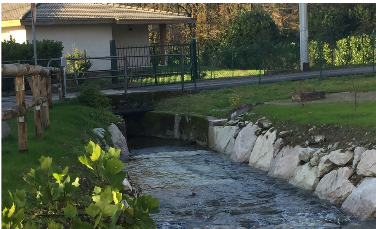
Foto 35 - Conoide Calciniate del Pesce, ponte di via Ettore Ponti (punto critico).
