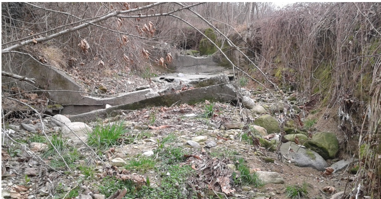
Foto 19 - Torrente Volturmo, briglie in calcestruzzo distrutte.
