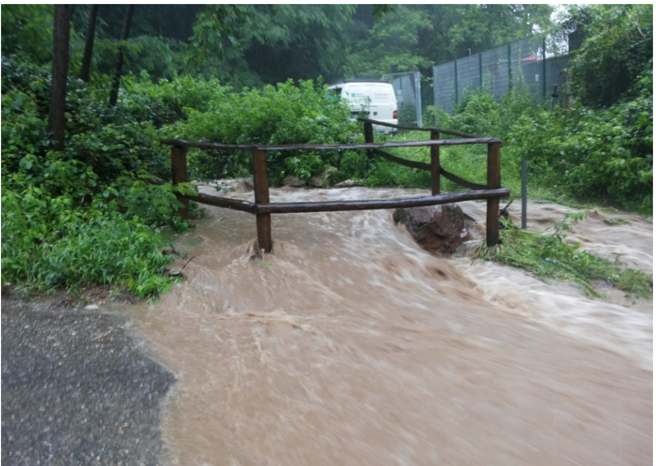
Foto 18 - Struttura idraulica insufficiente nei momenti di piena.
