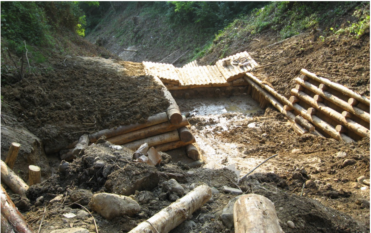
Foto 13 - Briglia realizzata nel Torrente Silvana per contenere i fenomeni di debris flow.
