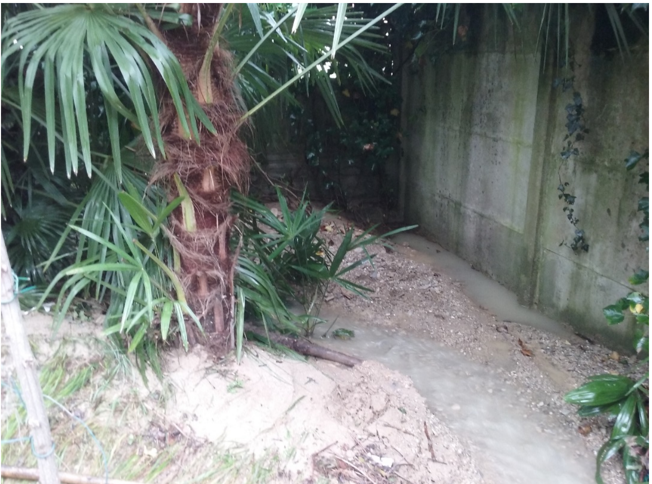
Foto 15 - Interramento tombotto terminale che conduce le acque al lago e spagliamento acque.
