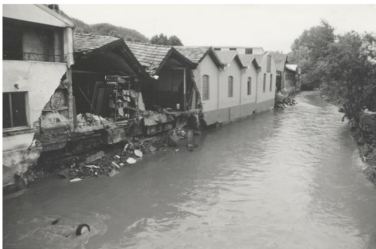
Figura 25 – Muri dello stabilimento Metalplast di Torba a Gornate Olona demoliti dall’urto dell’onda di piena del Fiume Olona. Fonte: Archivio CNR IRPI Torino.
